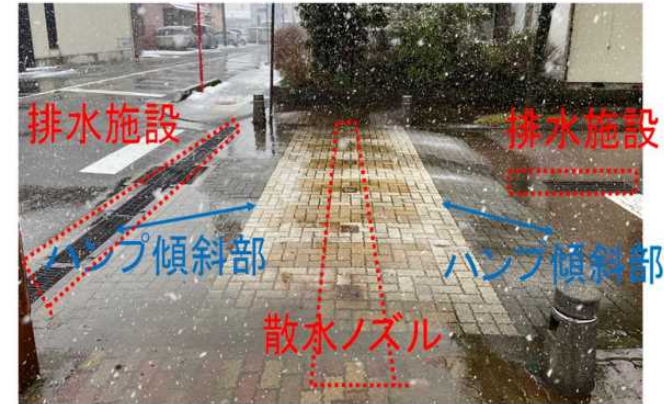
消雪パイプを設置したハンプ
