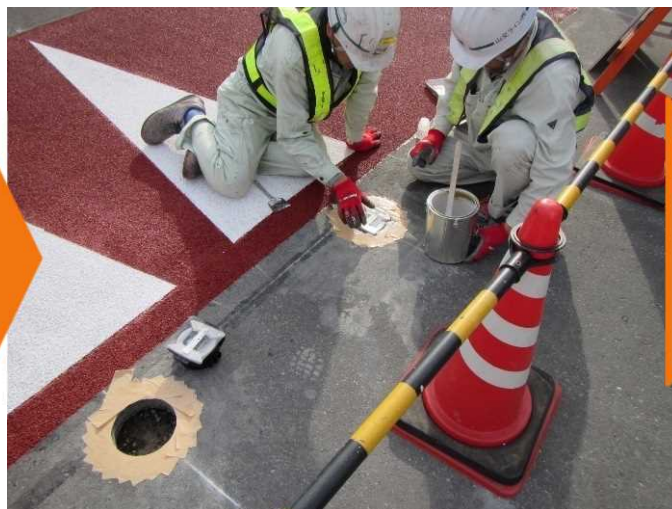
自発光道路鋏設置
